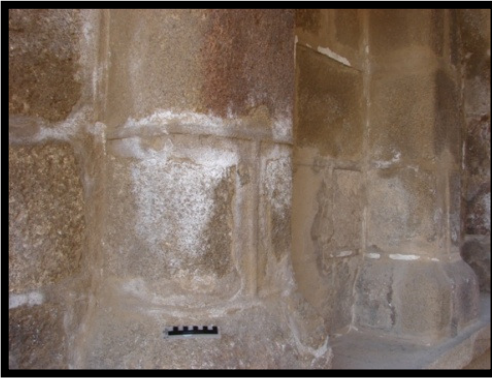
Figura 13 – Patologias no Arco do Bispo (eflorescências e desagregação granular intensa)
