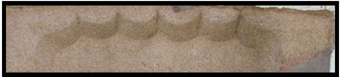
Figura 22 –A deterioração da rocha condiciona a perda de detalhes decorativos
