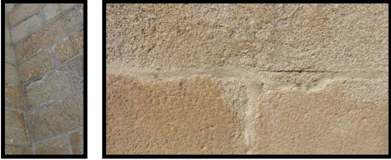
Figura 26 – Desagregação nas zonas de contacto
