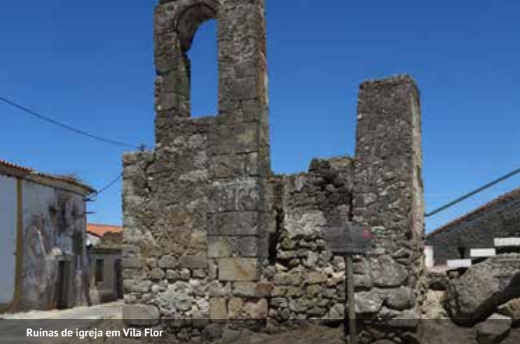
Ruínas de igreja em Vila Flor
